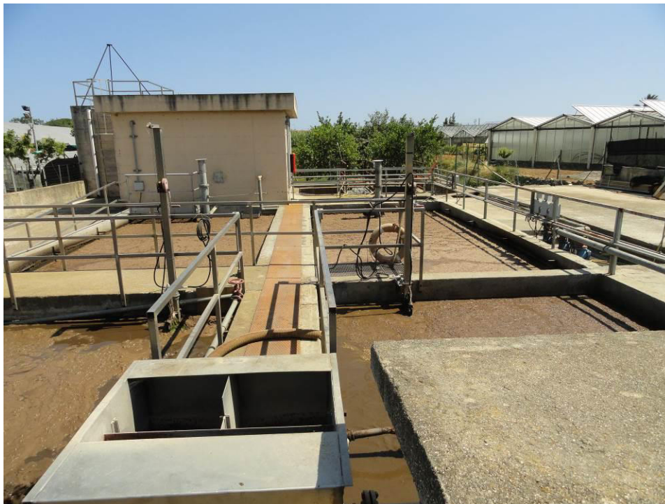
Figura 15 – impianto di depurazione esistente in comune di Albenga – loc. Campochiesa
