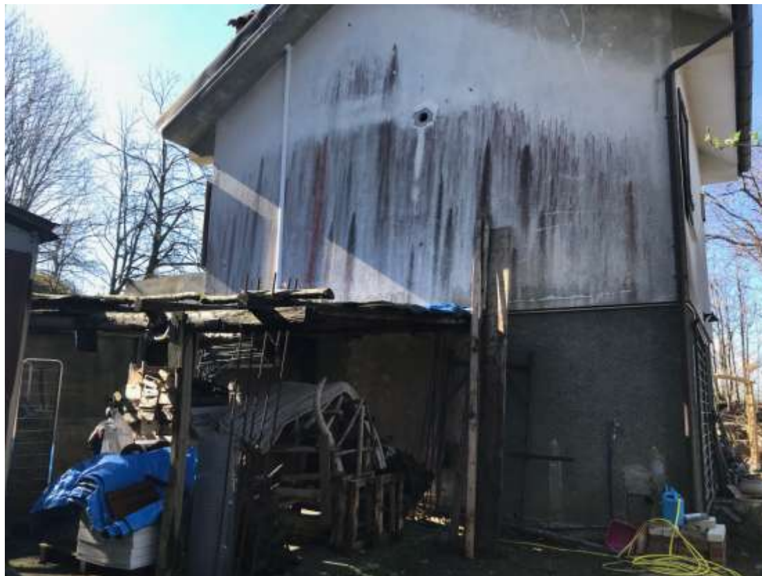
04,05_ Facciata Nord dove avverrà l'ampliamento, si può notare il degrado estetico che verrà migliorato a seguito dell' intervento
