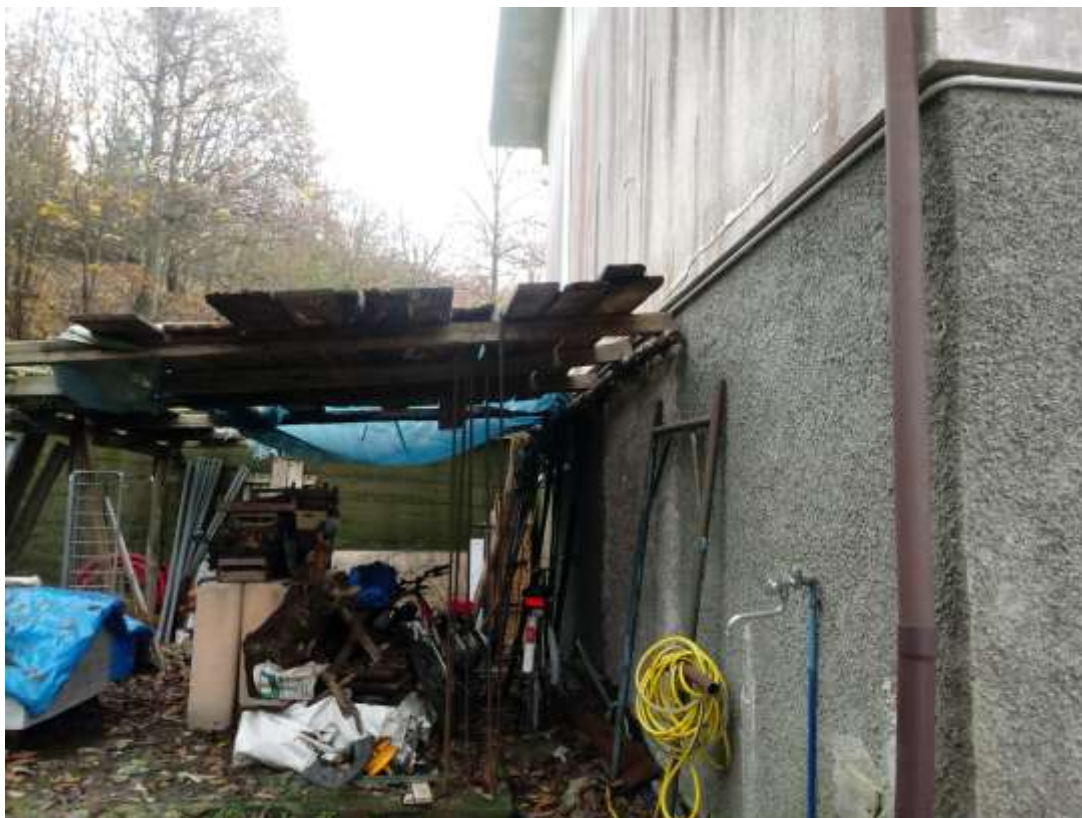
06_Zona a Nord dove avverrà l'ampliamento, ove si nota la tettoia pericolante e il basamento in cemento
