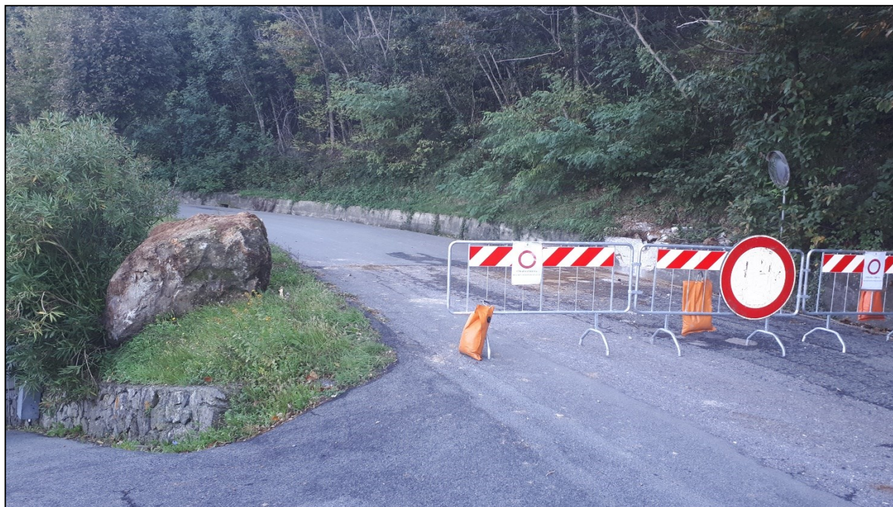
Figura 1: masso distaccato lungo la viabilità in loc. Mezzano - 2019
