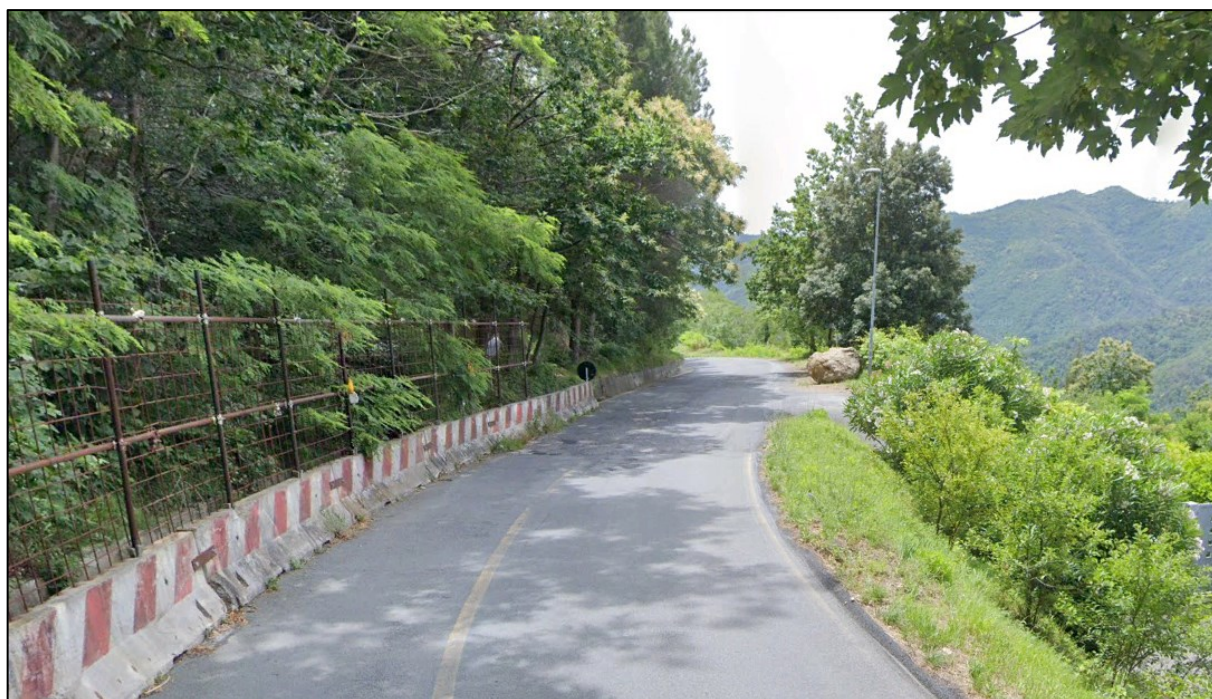
Fig. 7- 8 - Viste del tratto di versante a monte della strada comunale del Mezzano, che sarà interessato dai lavori
