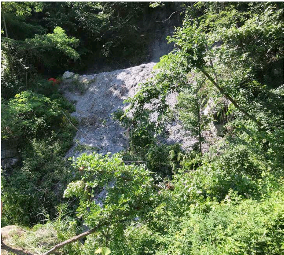
4. Vista del tratto di frana sottostrada
