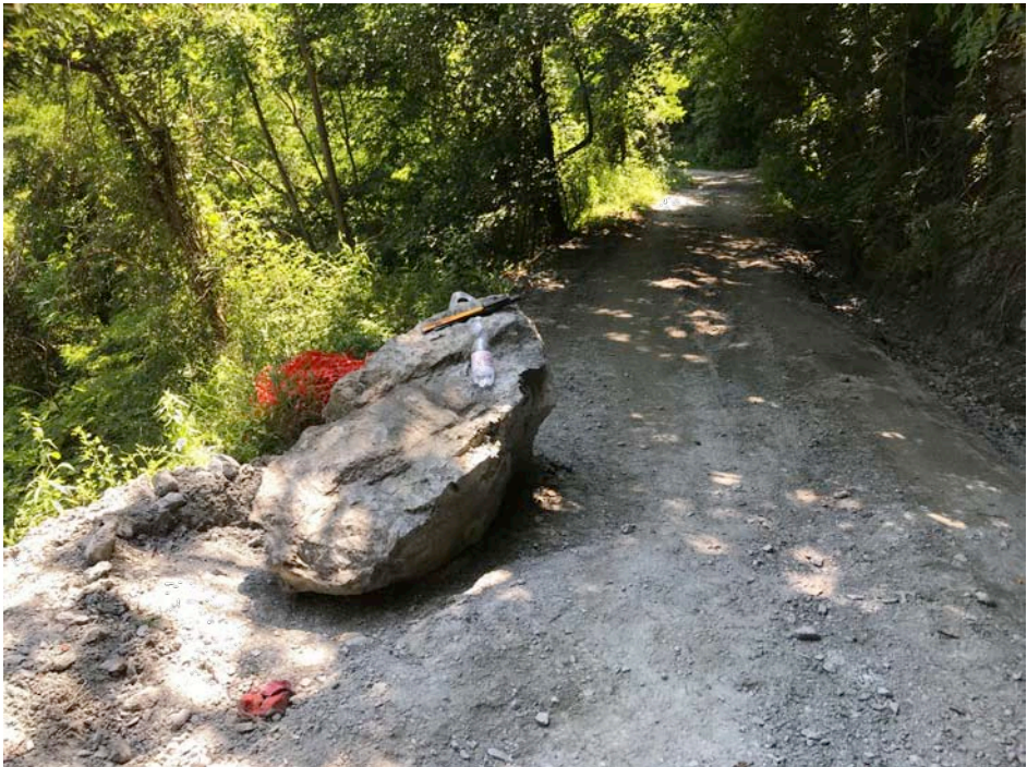
5. Vista del tratto di strada interessato dal movimento franoso
