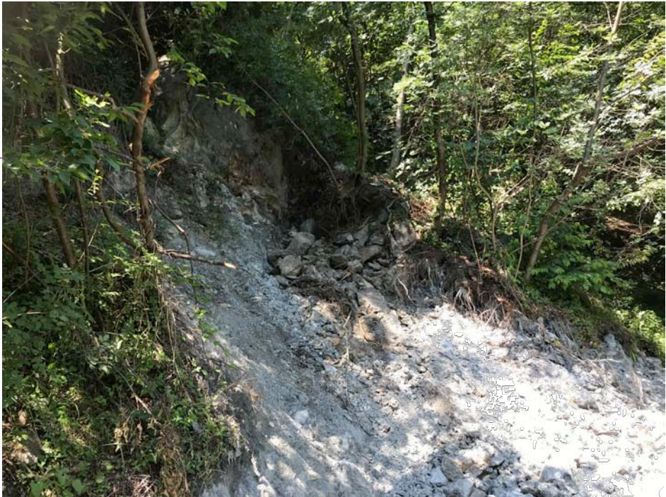
6. Vista del tratto di frana soprastrada
