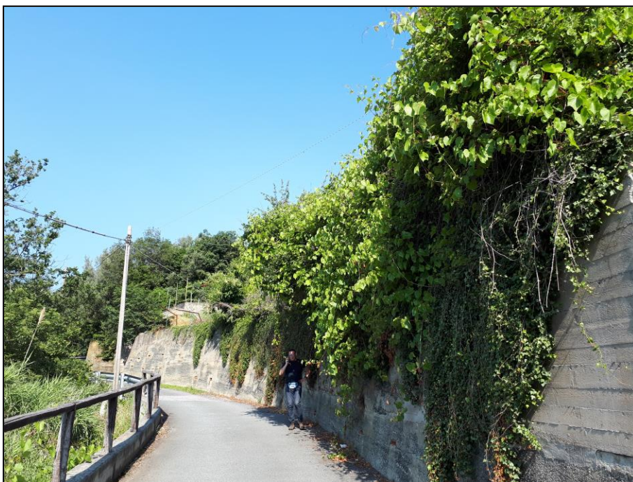
Vista del muraglione che sostiene la zona di intervento sopra la strada Frazione Gameragna
