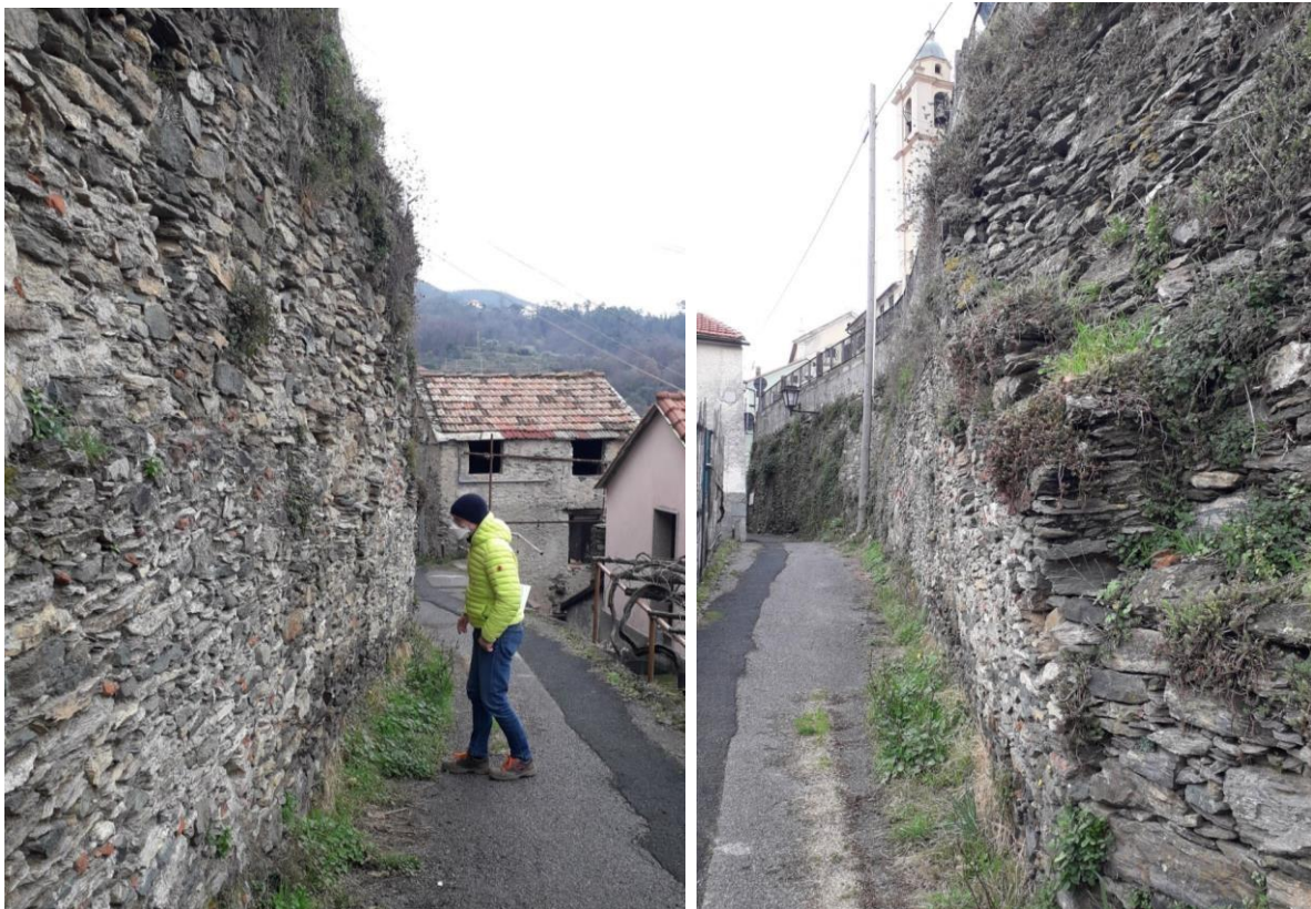
Foto 1÷2 Paramento lesionato e "spanciato"
