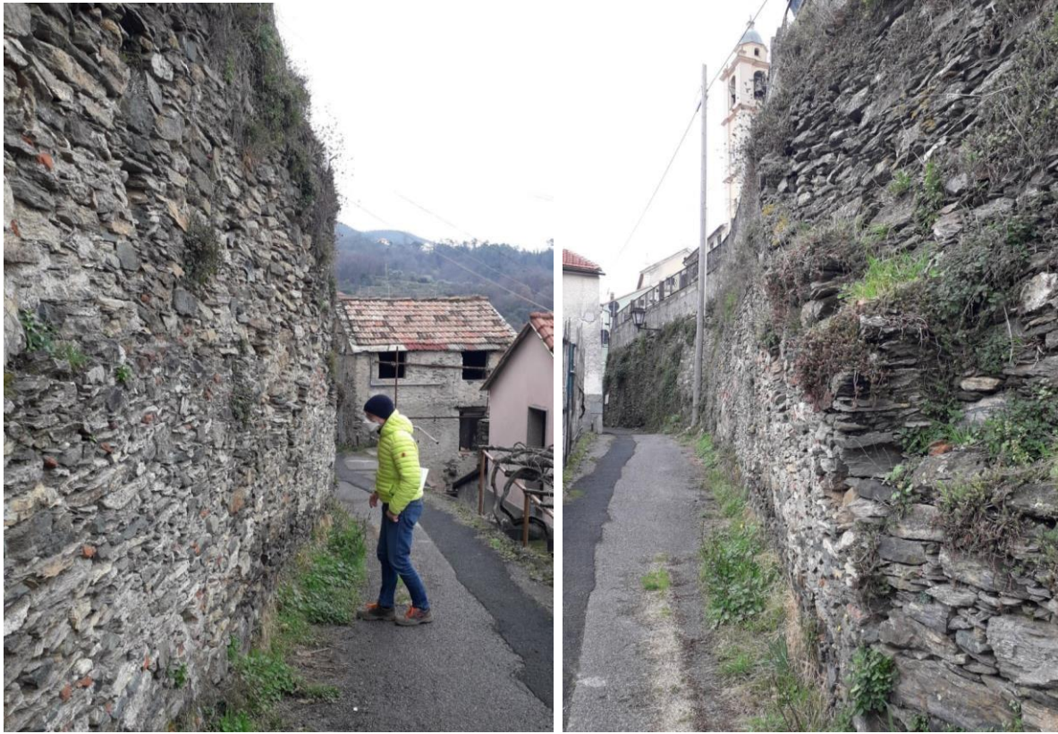
Foto 1÷2 Paramento lesionato e "spanciato"
